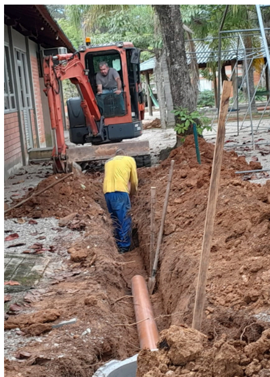
REDE DE ESGOTO
